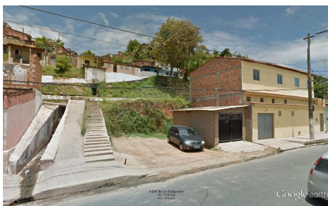
Figura 76 – Av. Maj. Cícero de Góes Monteiro (em frente ao Campo de Mutange) – Piso irregular da escada, rampa muito íngreme, ausência de corrimões
