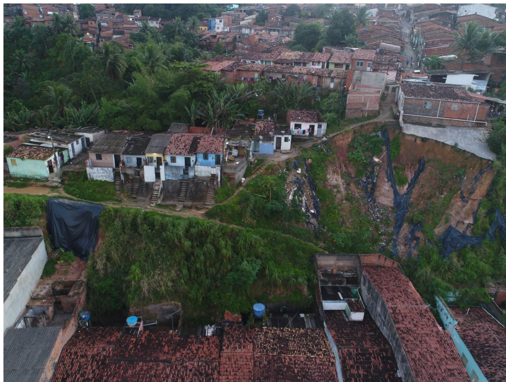
Figura 1 - Casas em situação de risco na encosta Marques de Abrantes.
