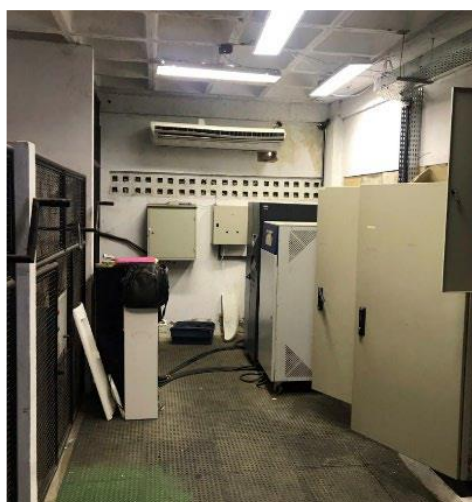
Figura 3 - Subestação um climatizador
