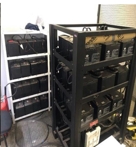
Figura 4 - Banco de baterias na subestação
