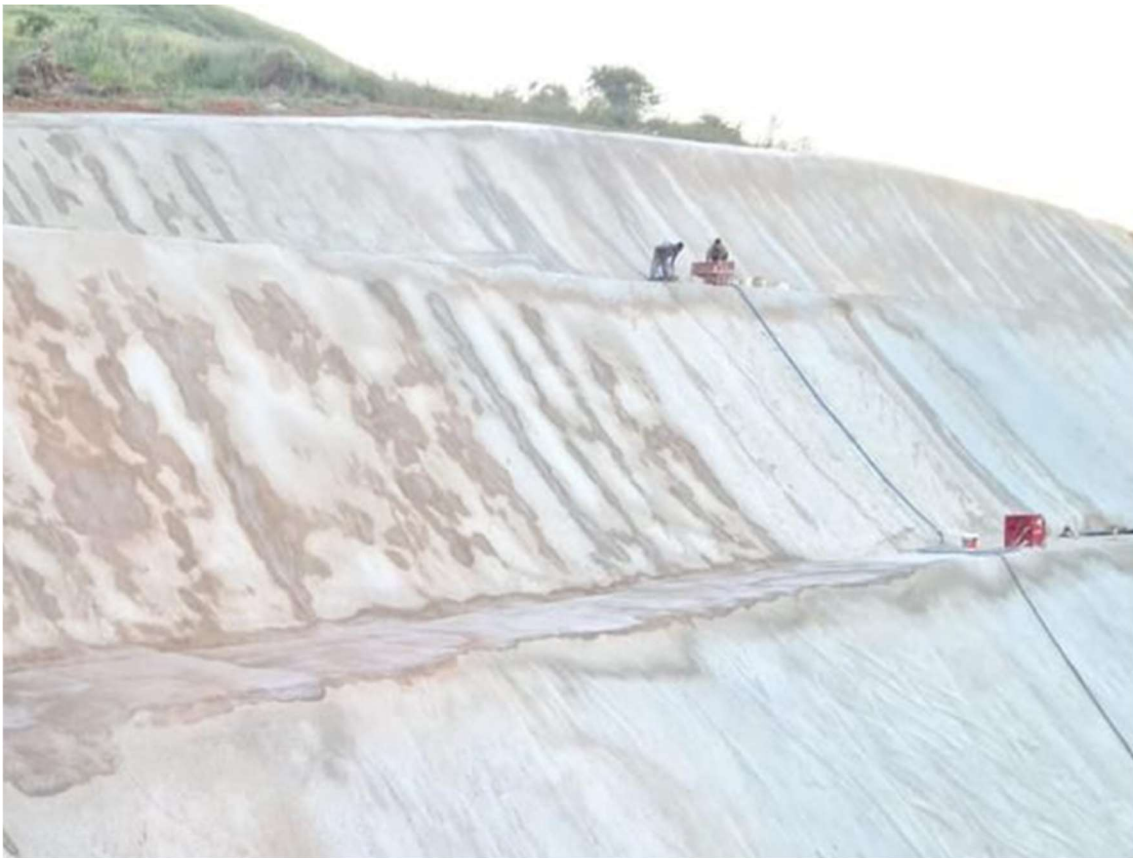
Figura 27 – Registros fotográficos da bomba jateadora de argamassa, sendo utilizada nos taludes da Rede FAVENI
