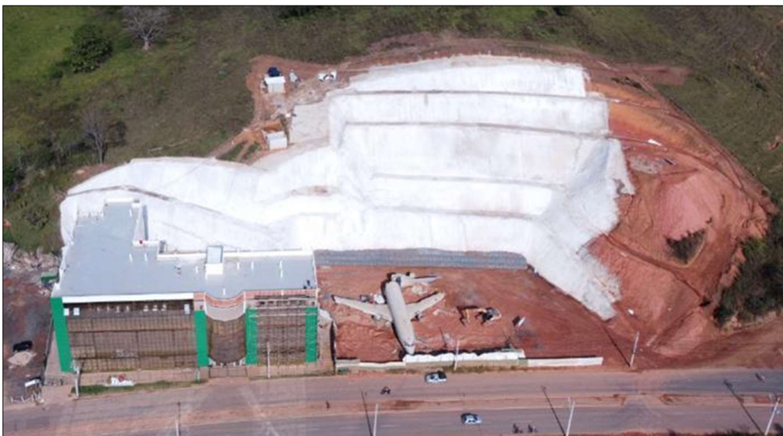
Figura 20 – Vista panorâmica da Sede da REDE DE ENSINO FAVENI, após jateamento de argamassa em todas as faces dos taludes protegidas com geomanta.
