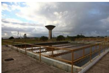
ESTAÇÃO DE TRATAMENTO DE ÁGUA (ETA) PRATAGY
